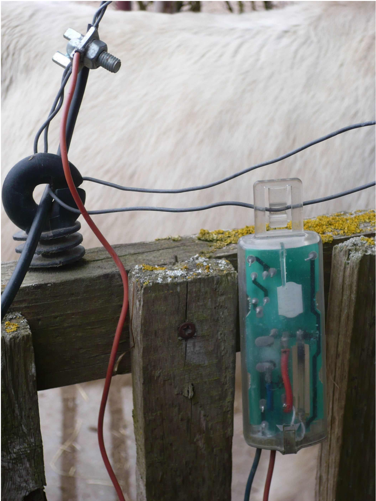
Blitzlichter, die mindestens 3000 V Zaunspannung anzeigen, haben sich gut zur Zaunkontrolle bewährt
